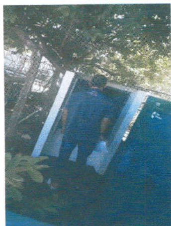
Figura 7. Manutenção preventiva gerador
