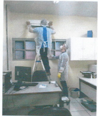
Figura 3 preventiva de ares-condicionados
